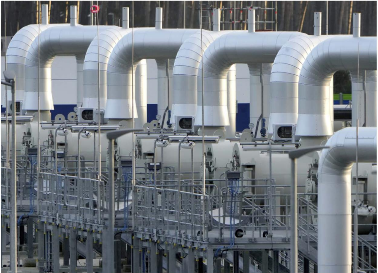
Gasledningen Nord Stream 2, fotograferad i Lubmin i norra Tyskland. Ledningen, som går från Ryssland till Tyskland under Östersjön, var driftsklar den 1 januari 2022. Men som en följd av den ryska upptrappningen mot en invasion av Ukraina meddelade Tysklands förbundskansler i slutet av februari att processen för licensiering pausats.
